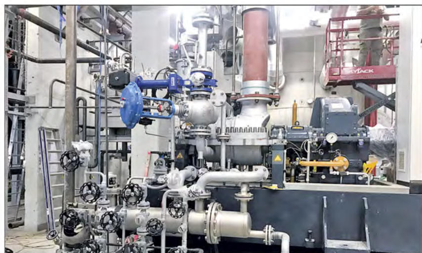
Dampfturbine mit Dampfverrohrung
