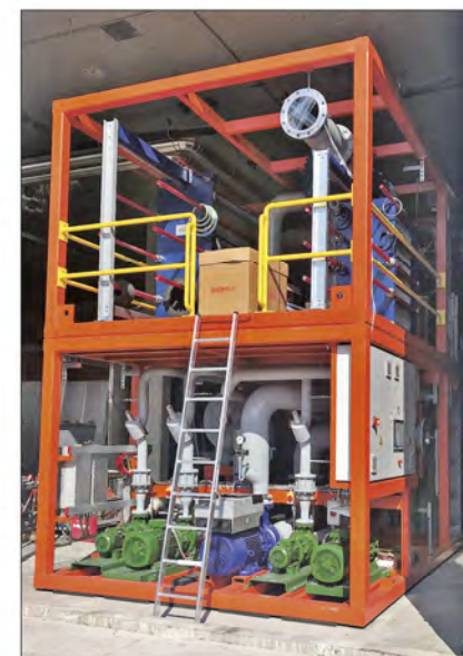
Die Absorptions-Kältemaschine stammt aus Bayern.
